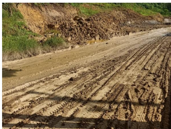
Gambar 1. Kondisi Tanah Longsor di Jalan Teluk Bajau
